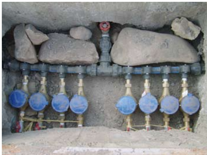
Regard installé à Imelghas
